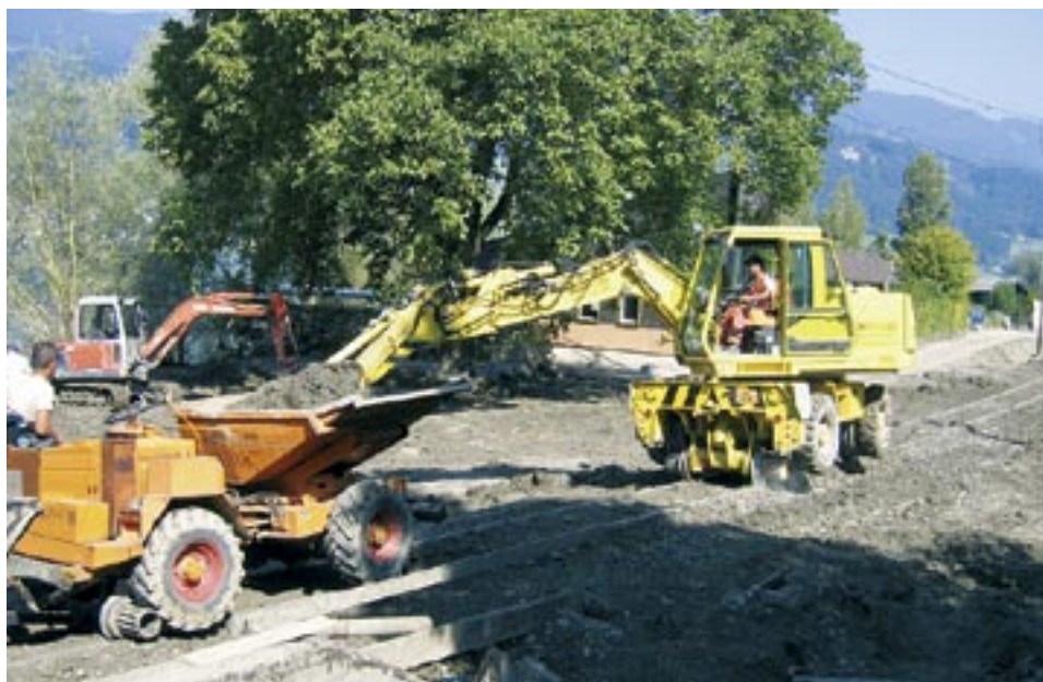
Unwetterschäden in Sarnen: Das Gleis konnte der Eisenbahn keinen richtigen Halt mehr geben.
