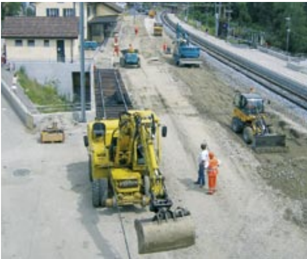
WEBER AG im Einsatz für die Unterbauerneuerung (Fundation und Schotter) im Bahnhof Aesch. Mitte Juli standen besonders intensive Wochenende auf dem Programm.
